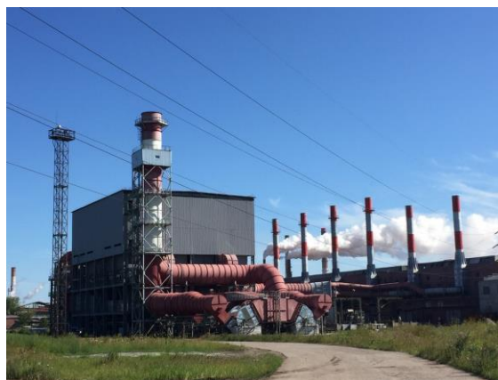
Один из проектов ИСД - газоочистная установка на заводе РУСАЛА в Каменск-Уральском. Запуск современной газоочистки позволил снизить выбросы пыли на 98%.
